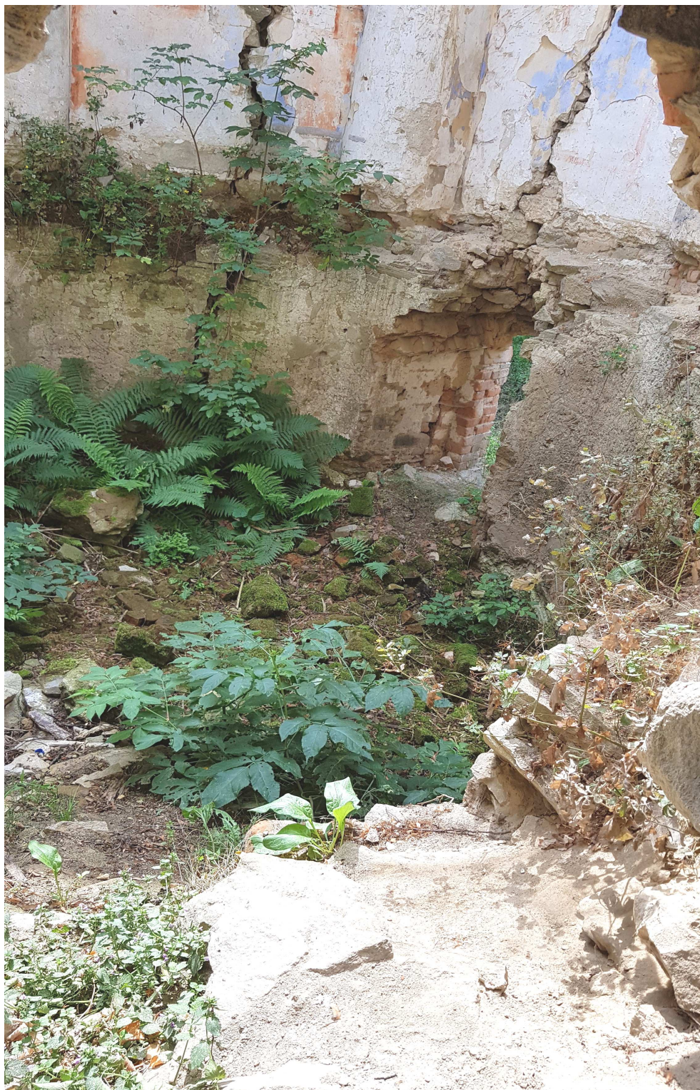
FOT. 11 Zagruzowana posadzka przyziemia – zawalone sklepienie
