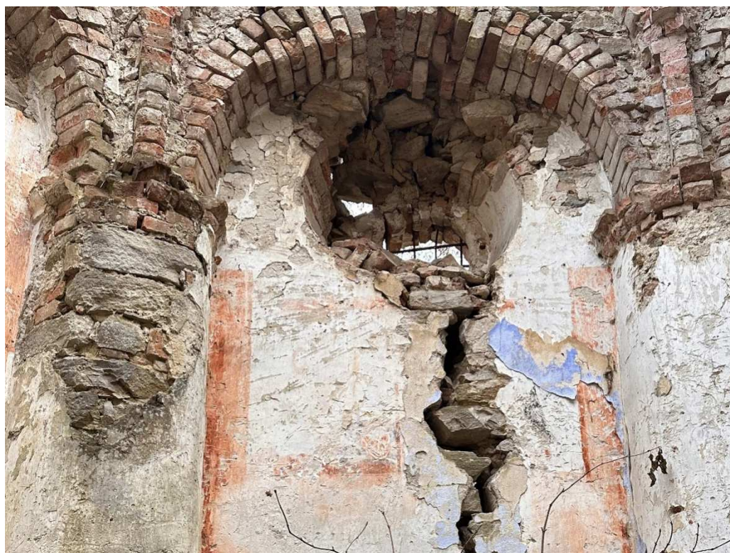
Fot nr 1 XVII wieczna baszta dworu obronnego w Kicharach. Widok wielkoobszarowych ubytków wypraw tynkarskich i sztukatorskich spowodowany czynnikami atmosferycznymi.
