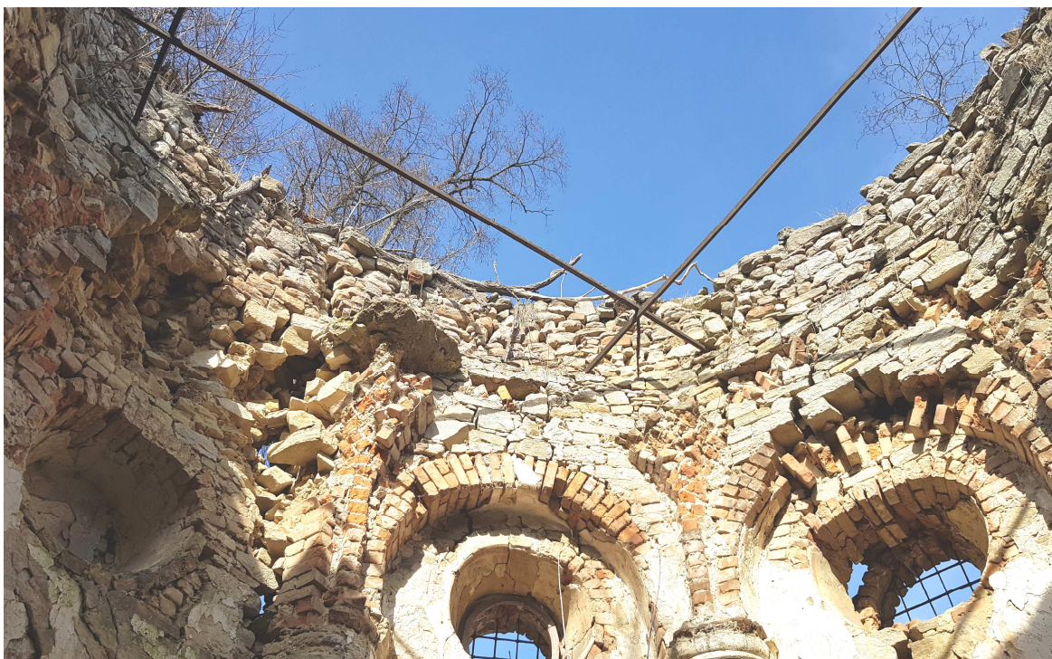
FOT. 25 Widok zawalonego sklepienia od wewnątrz w osiach 2 — 5
