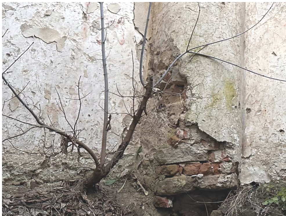
Fot nr 4 XVII wieczna baszta dworu obronnego w Kicharach. Widok ubytków w strefie cokołowej powstałymi w wyniku obecności soli budowlanych.
