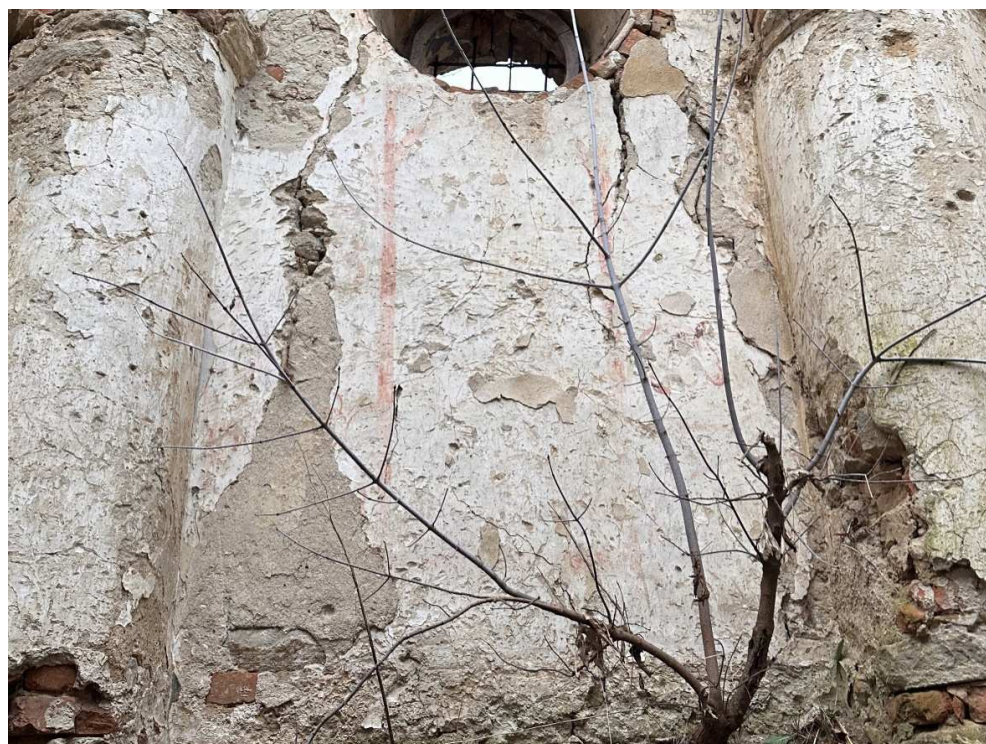
Fot nr 5 XVII wieczna baszta dworu obronnego w Kicharach. Widok wtórnych zapraw na powierzchniach ścian występujących w strefie spękań konstrukcyjnych muru.
