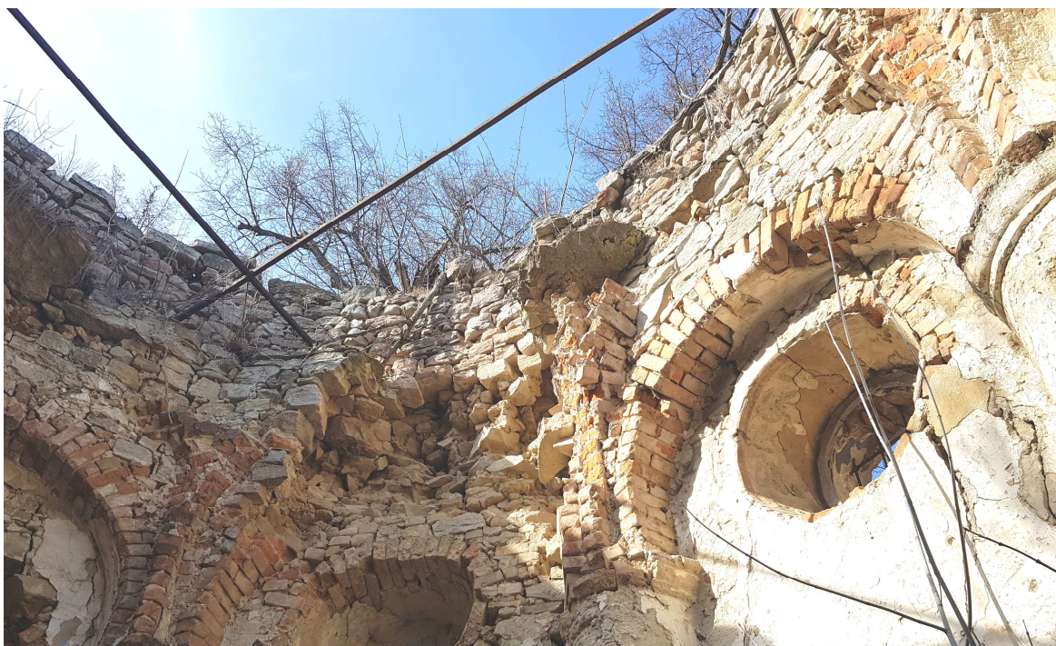
FOT. 24 Widok zawalonego sklepienia od wewnątrz w osiach 1 — 3
