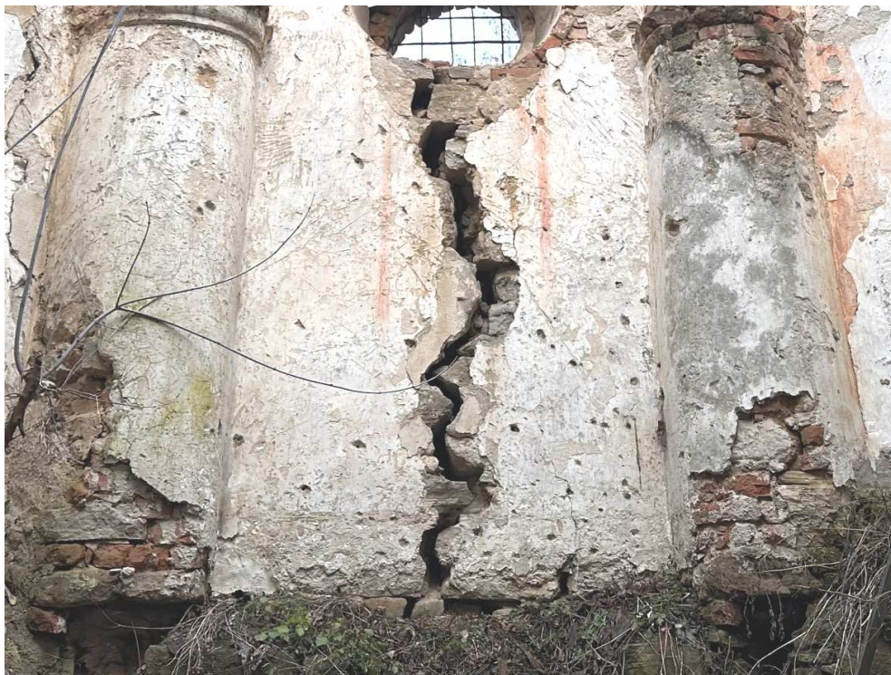
Fot nr 2 XVII wieczna baszta dworu obronnego w Kicharach. Widok ubytków w strefie cokołowej powstałymi w wyniku obecności soli budowlanych.
