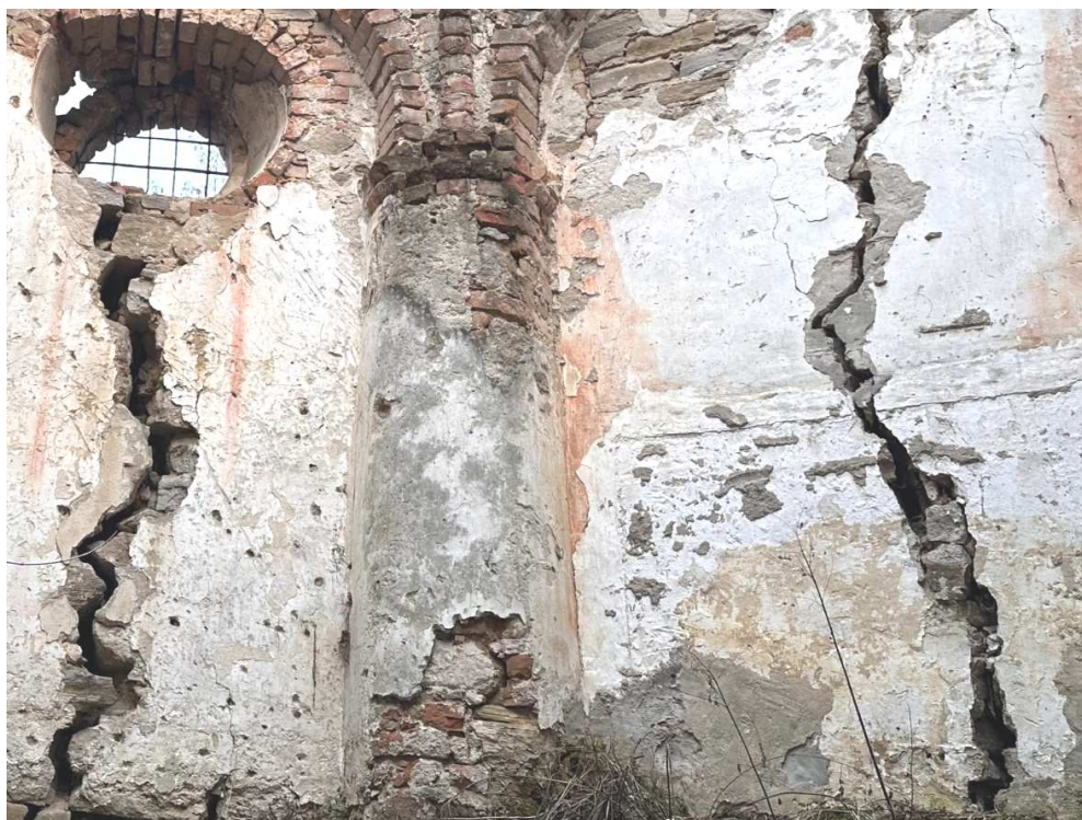
Fot nr 3 XVII wieczna baszta dworu obronnego w Kicharach. Widok ubytków w strefie cokołowej powstałymi w wyniku obecności soli budowlanych.
