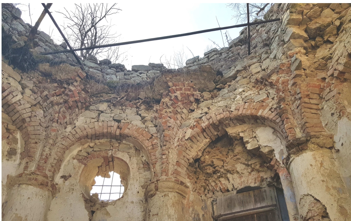
FOT. 23 Widok zawalonego sklepienia od wewnątrz w osiach 7 — 1
