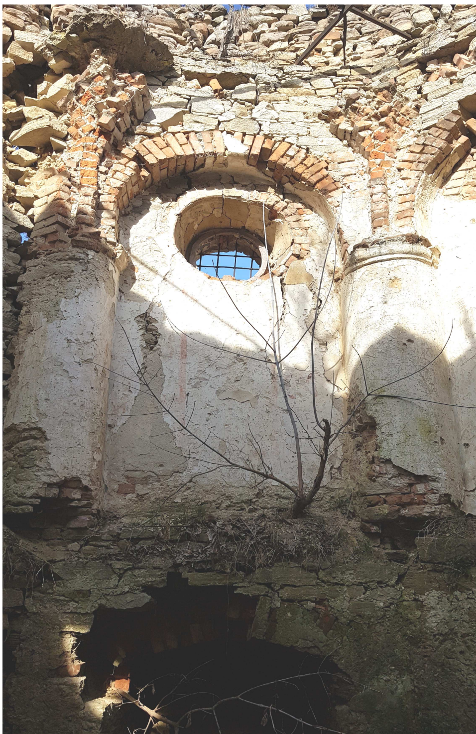
FOT. 14 Widok ścian od wewnątrz z nisza w przyziemiu w osiach 2 — 3
