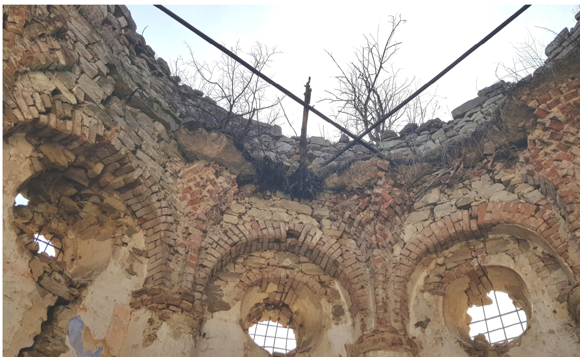
FOT. 22 Widok zawalonego sklepienia od wewnątrz w osiach 5 — 8
